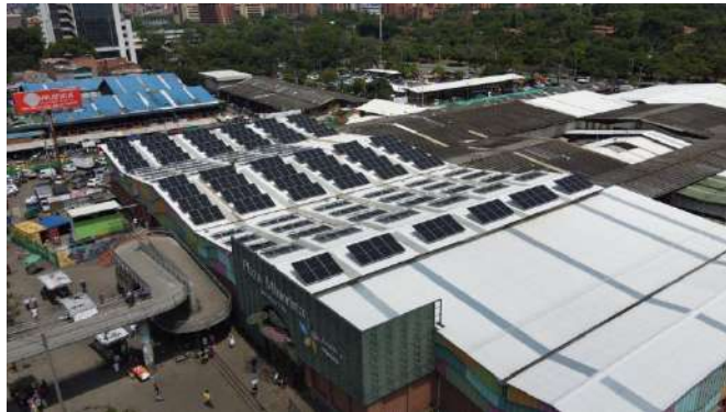
Sistema de Energía solar
